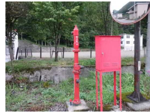
背の高い消火栓
